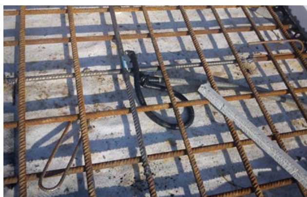
Fot. 3. Widok zainstalowanych czujników pomiarowych
